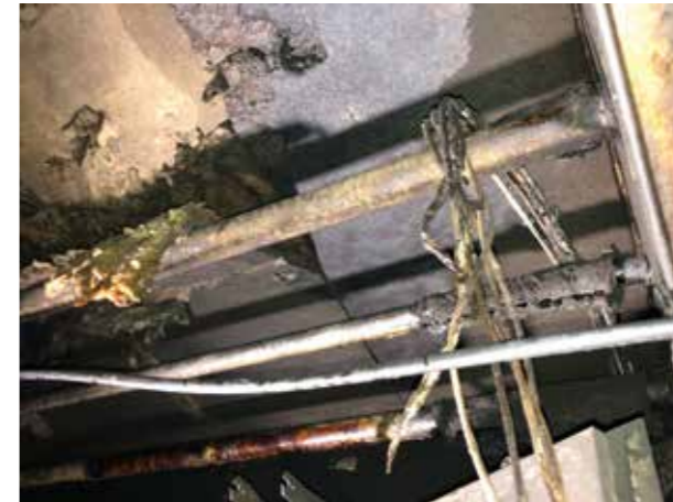
Die Kellerbrände zerstörten unter anderem die Elektroleitungen. Es kam zu Stromausfällen.
